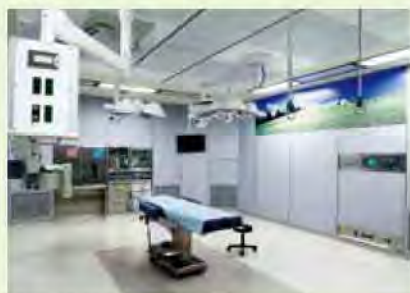
バイオクリーンルーム(手術室)
